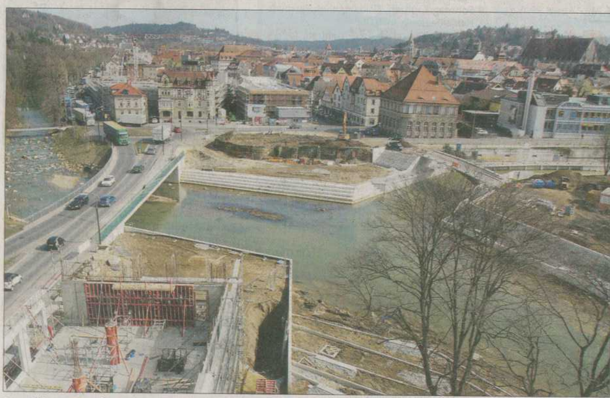
Der völlig neu gestaltete Mündungsbereich Josefsbach/Rems mit Terrassen und Strand bildet das Herzstück des Remsparks, mithin der Landesgartenschau. Hier ein Blick vom Baukran (weitere Bilder im Internet unter remszeitung.de ). Foto: hs
